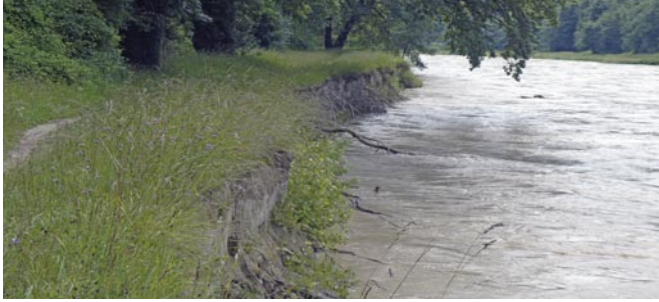
Bei einem Hochwasser können Erdmassen an den Flussufern abgetragen werden, wie hier entlang der Thur westlich des Eggranks.
